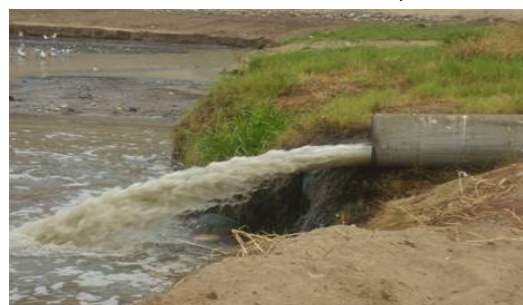
Figura 3.4.- Tubería de SEDA CHIMBOTE para descarga de efluentes domésticos. (Foto G. Sánchez, 2008)
