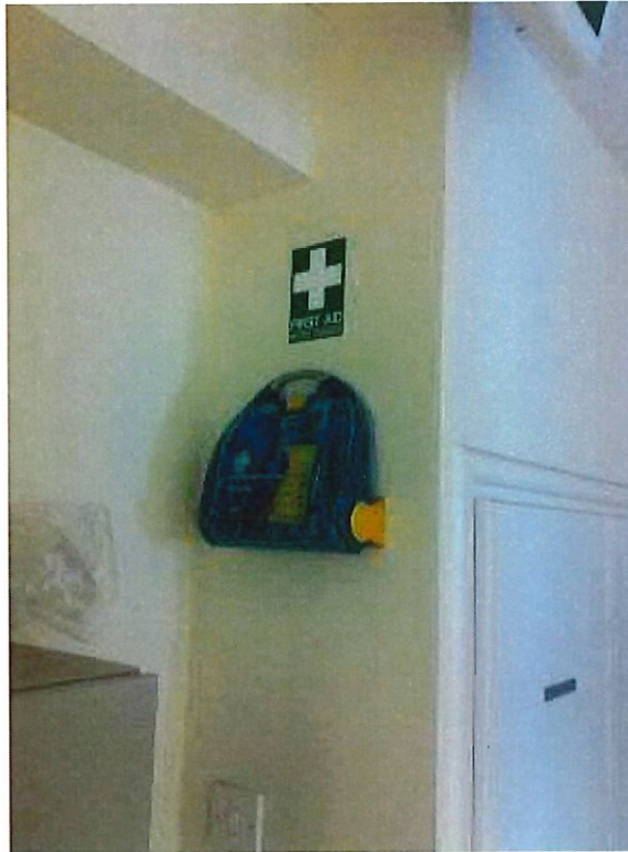
Φωτ. 10. Κουτί πρώτων βοηθειών στον τρίτο όροφο του κτηρίου
