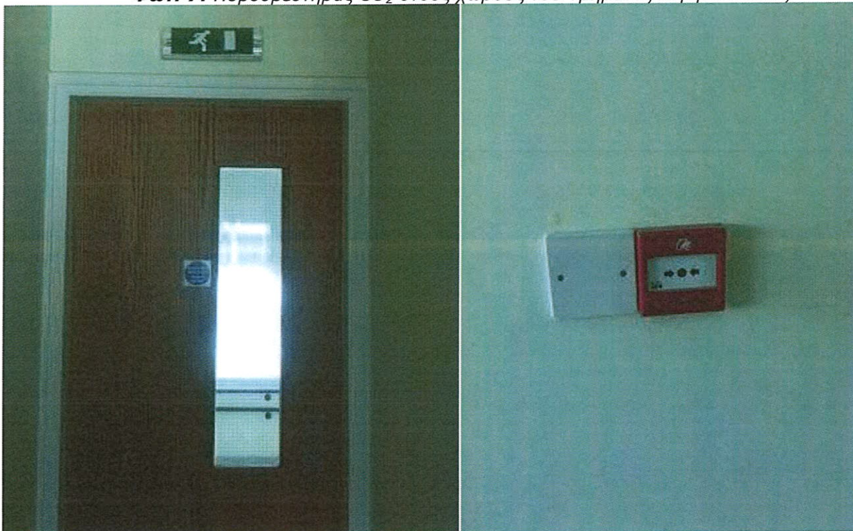
Φωτ. 8-9. Πυρίμαχη πόρτα και συναγερμός πυρκαγιάς στους χώρους της υπηρεσίας
