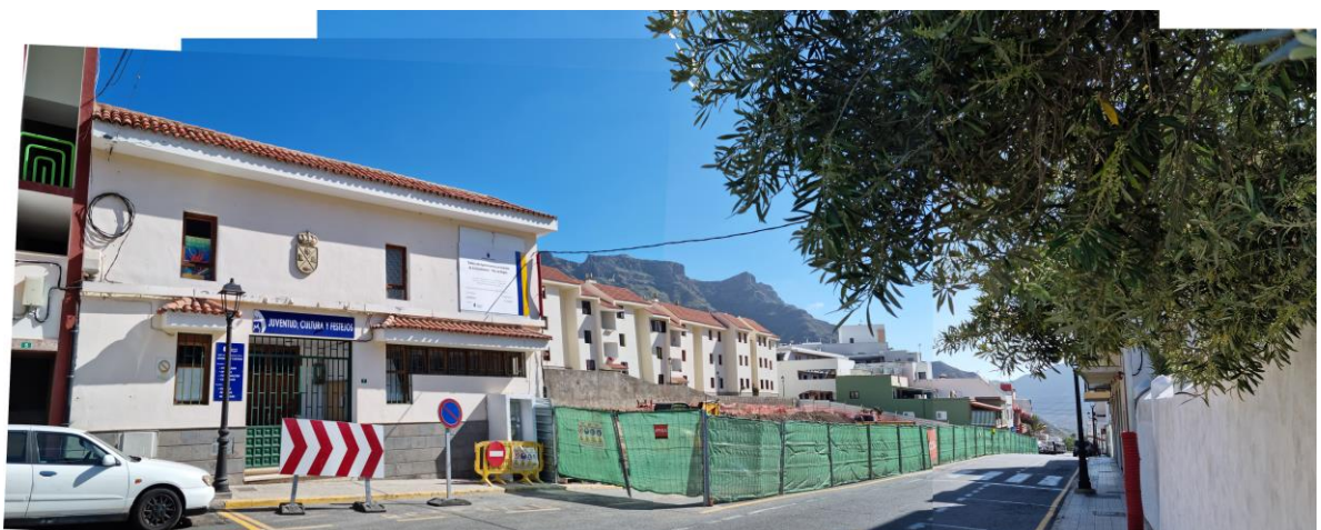
Imagen de la Avda. de La Constitución y la obra relativa a la Ordenanza Zona X. Fuente: LPA Studio.
