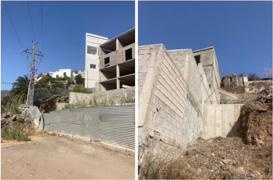
Impactos localizados en el encuentro entre el barranco y las edificaciones existentes. Fuente: Ayuntamiento de Mogán.
