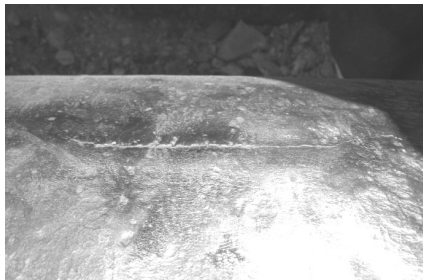
Podélný defekt na potrubí – trhlina
