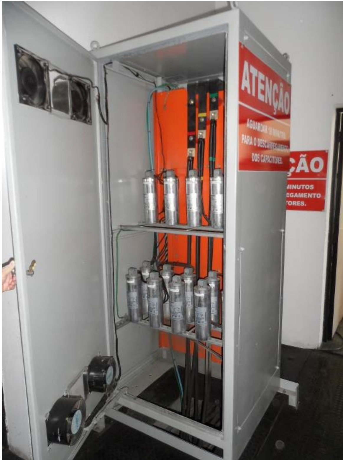
Bank von Kondensatoren
