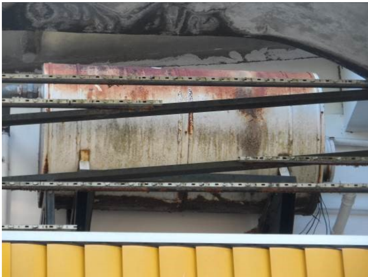
45-thermische Reservoir mit Korrosion.
