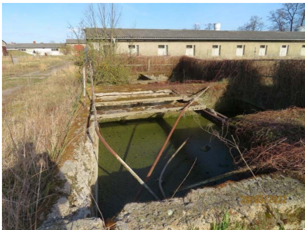
Wassergefüllte Sammelgrube Sauenanlage westlich Mitte
