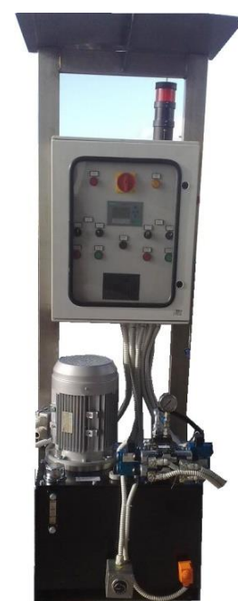
Quadro elettrico e Centralina Oleodinamica
