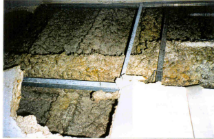
Fotografia n. 9 - Amianto spruzzato a soffitto visibile dopo rimozione di controsoffittature
