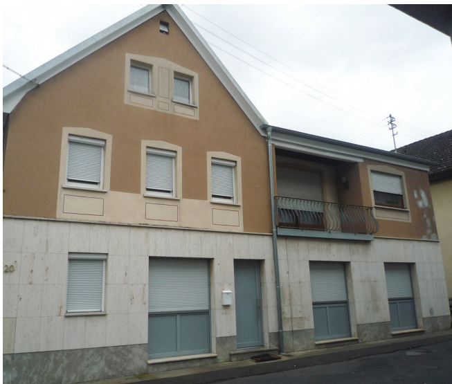
Negativbeispiel: nicht abgestimmte, unpassende Fassadengestaltung
