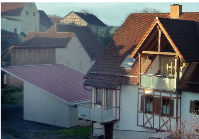
Negativbeispiel: Dach durch Gauben überformt, nicht passendes Pultdach mit Metalldeckung
