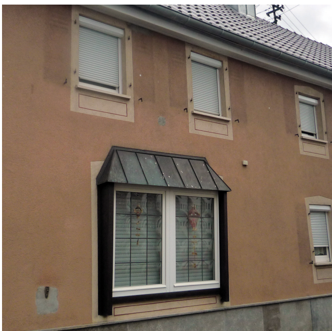
Negativbeispiel: nicht abgestimmte, unpassende Fassadengestaltung
