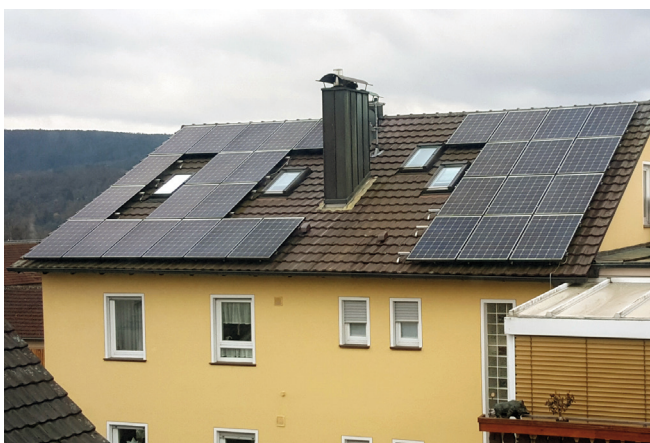
Negativbeispiel: Ungeordnete PV Anlagen verunklaren Dachlandschaft
