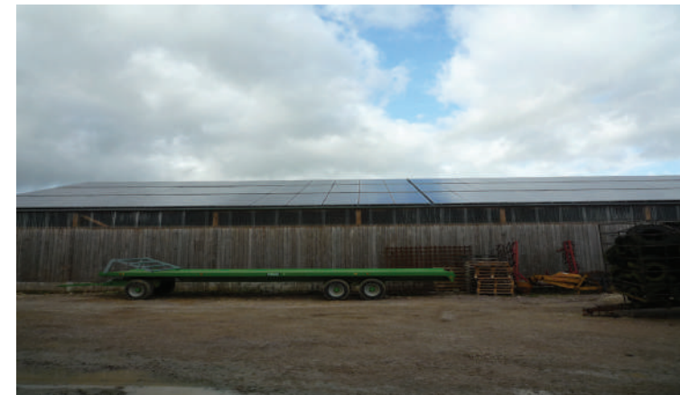
Illustration 3 : Installation photovoltaïque sur bâtiment agricole
