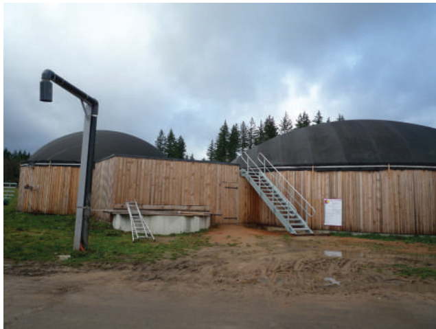
Illustration 4 : Installation de méthanisation agricole à la ferme de l'Abbaye de la Pierre qui Vire
