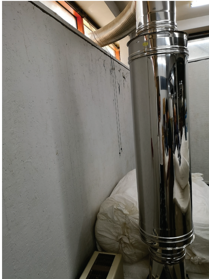
Εικόνα 6: Ο εγκατεστημένος σιγαστήρας του απαγωγικού συστήματος του μηχανήματος μόνωσης πριν την έξοδο από το υπόγειο
