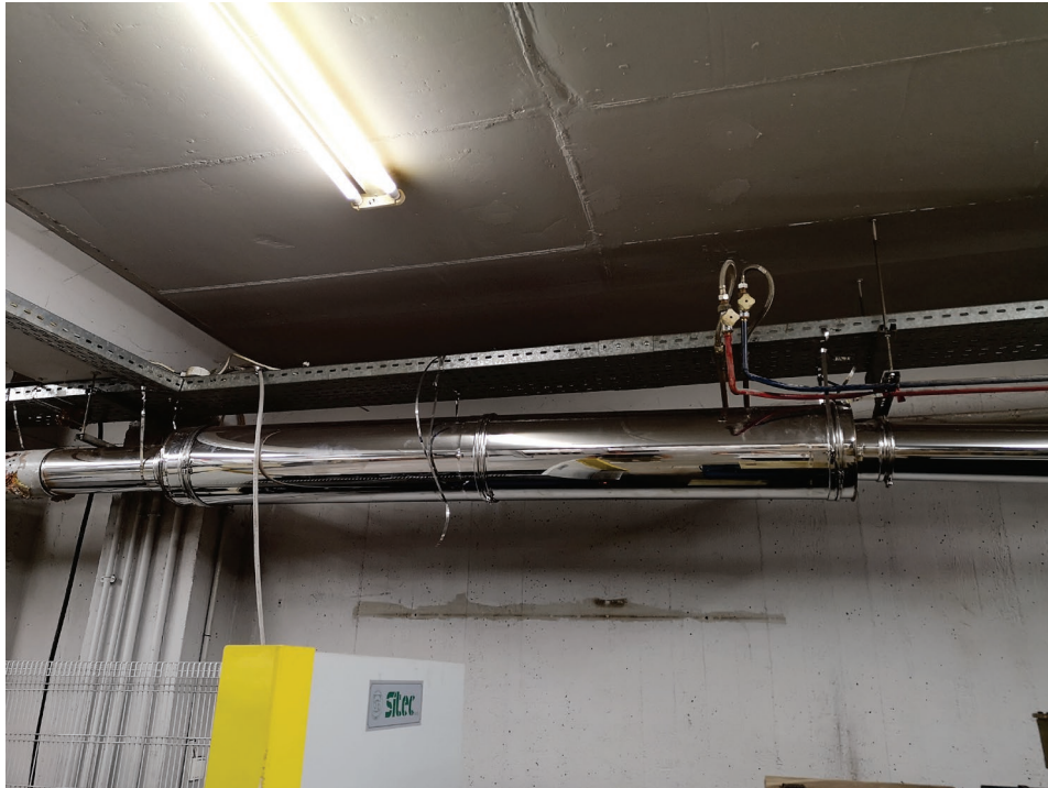
Εικόνα 4: Ο εγκατεστημένος σιγαστήρας του απαγωγικού συστήματος του μηχανήματος κοπής πριν την τελική έξοδο
