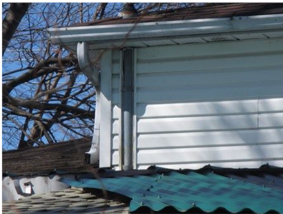
Le mât électrique n'a pas été enlevé avant la pose du revêtement de vinyle ce qui rend l'installation à haut risque d'infiltration d'eau
