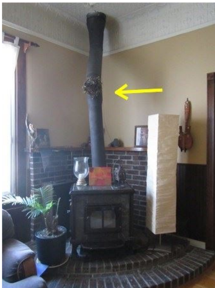
Le poêle au bois et le conduit de fumée mal assemblé
