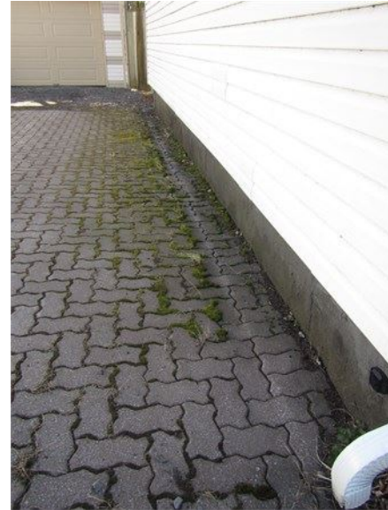
Affaissement du pavé uni sous l'écoulement des eaux du toit qui est sans gouttière du côté gauche
