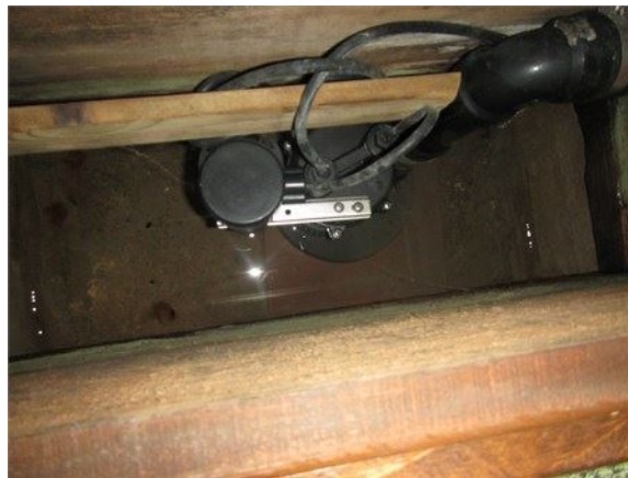
Le puisard installé du côté gauche du sous-sol, partiellement sous le mur, ce qui n'est pas souhaitable
