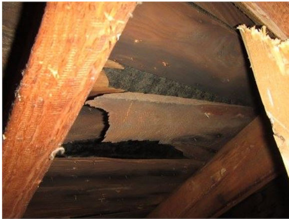
Planche de platelage arrachée
