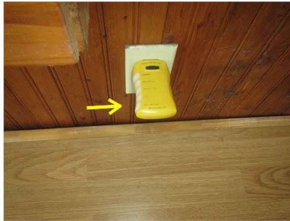
Prise non fonctionnelle dans la pièce non chauffée
