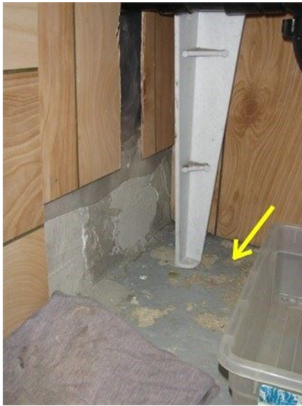
Vieille dalle de béton au sous-sol : La peinture écaille habituellement en présence d'humidité excessive/eau
