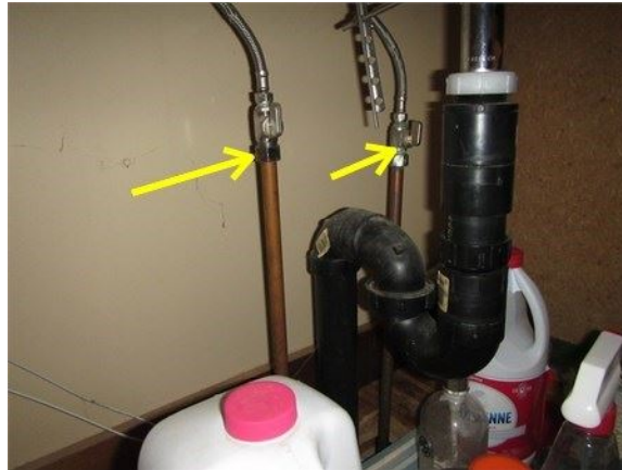
Exemple d'absence d'anti-béliers sur des conduites d'eau sous un appareil
