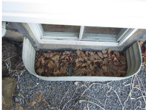
Margelle à nettoyer : on doit trouver que du matériau drainant
