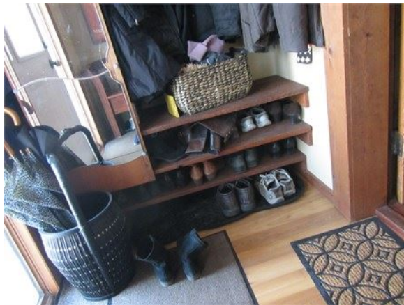
Le plancher du portique d'entrée (extension) penche vers l'avant
