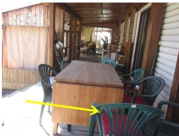
La terrasse penche de manière importante vers la maison, côté gauche
