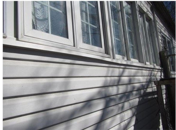
Fenêtres mal assemblées sur le mur latéral droit
