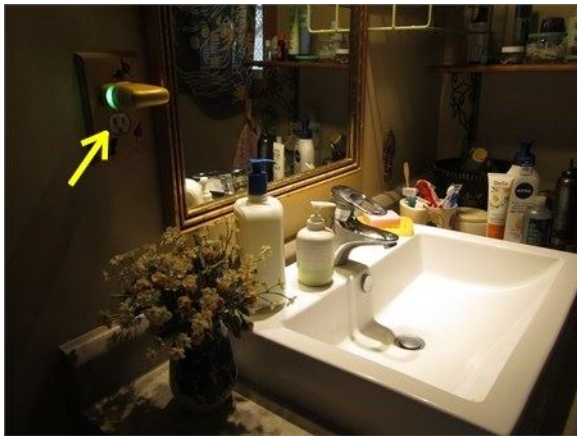
Prise sans DDFT Salle de bains arrière centre
