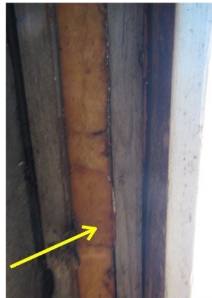
Dessous des murs fermé sans ventilation
