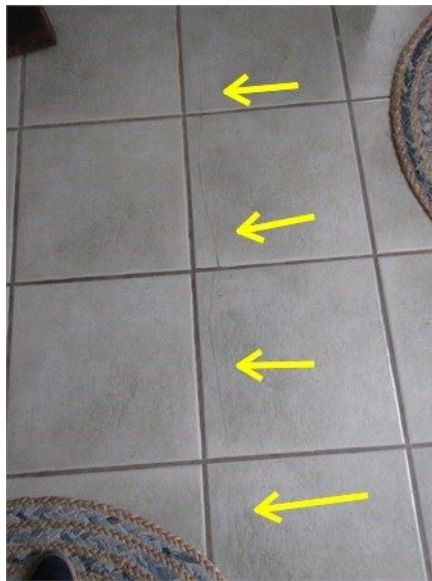
Fissure rectiligne dans des carreaux de la salle de bains avant droite
