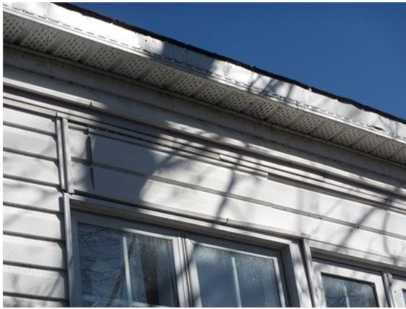
Assemblage bricolé sur le mur latéral droit
