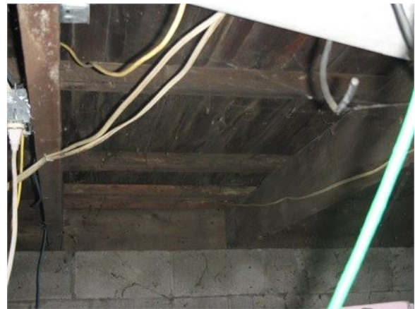
Exemple de structure faible, vide sanitaire gauche : Les solives sont très espacées les unes avec les autres et les travers très petits
