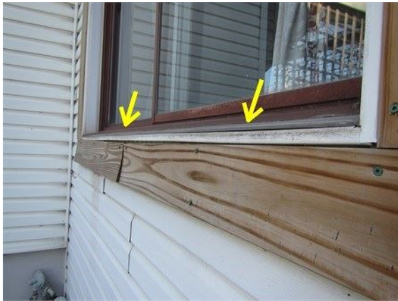
Absence de solin au-dessous d'une fenêtre en guise d'exemple
