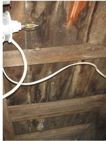
Taches sur des solives et le platelage de bois qui pourraient comporter des moisissures, vide sanitaire droit
