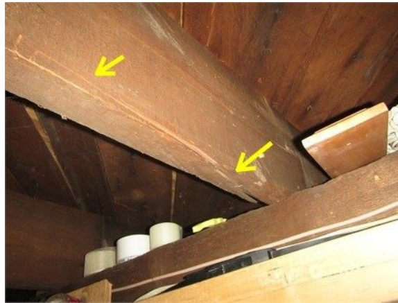
Solive cassée près de la fournaise au sous-sol
