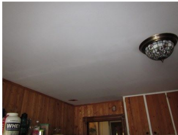
Joints mal tirés au plafond de la salle à manger
