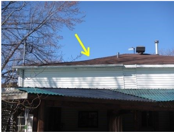
Structure de toit faible
