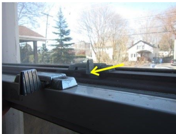
Certaines sections de fenêtre à guillotine ne verrouillent plus
