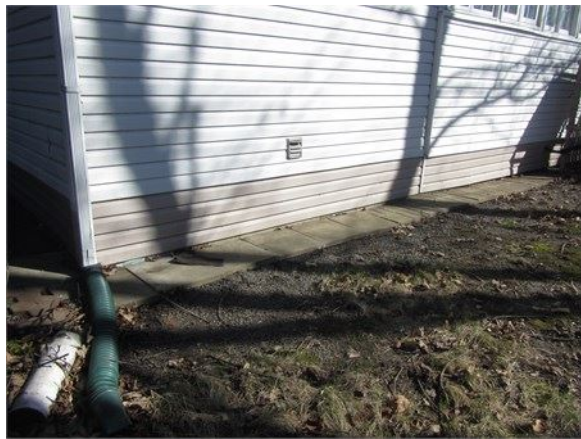
Revêtement de vinyle jusqu'au sol au lieu de s'arrêter à 8 po du sol
