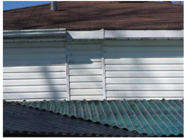
Assemblage inapproprié sur le mur arrière sans joints d'étanchéité de part et d'autre de la réparation
