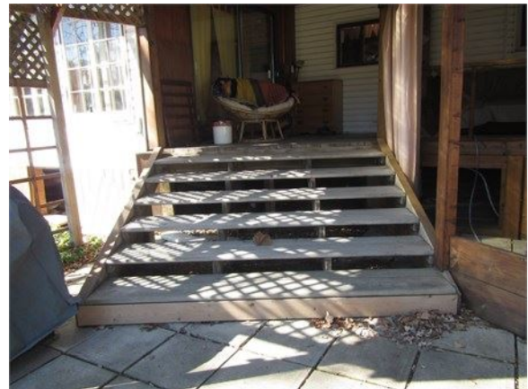
Absence de mains courantes et de garde-corps dans l'escalier arrière droit
