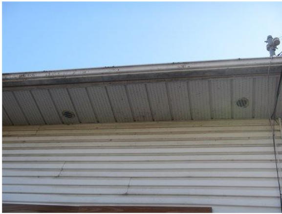
Soffites ventilés avec grilles additionnelles en raison des percements des soffites en bois situés sous les soffites en aluminium
