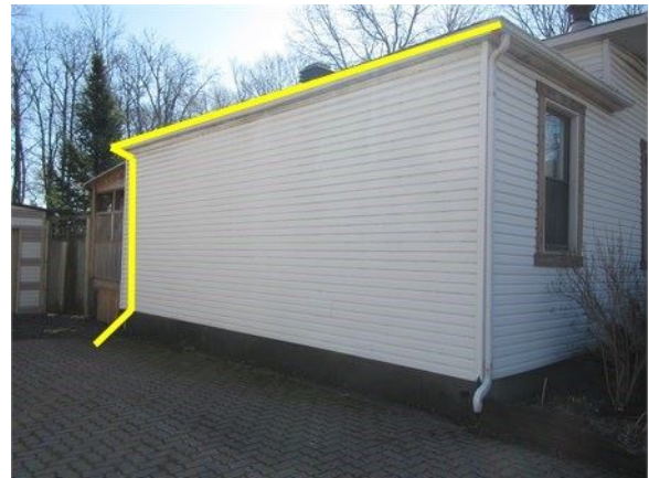
Absence de gouttière du côté gauche
