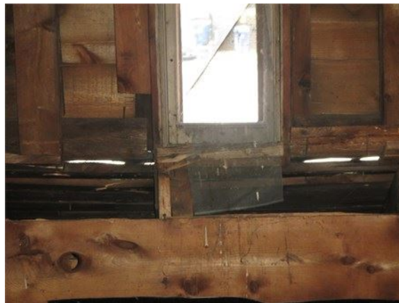
Absence d'étanchéité sous la lucarne avant dans l'entretoit
