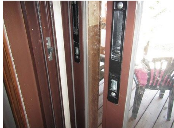
La porte-fenêtre ne verrouille plus dans certaines sections
