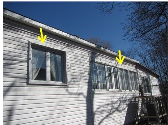
Absence de solins au-dessus des fenêtres et infiltrations d'eau au haut des fenêtres de la salle à manger (flèche droite)
