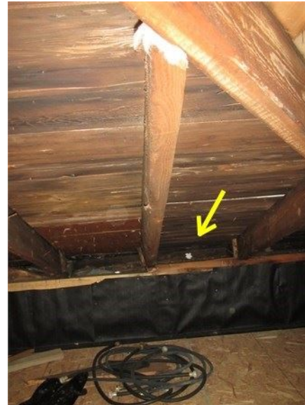
Faible ventilation sur le débord de toit arrière en guise d'exemple
