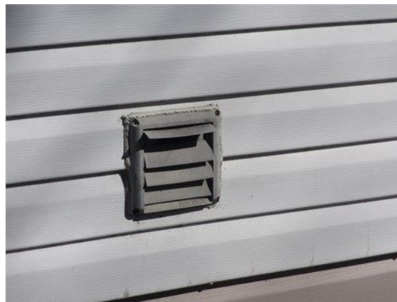
Registre d'évacuation à remplacer sur le mur latéral droit
