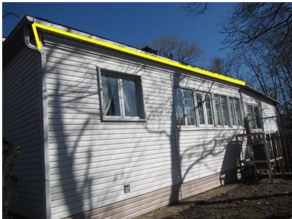
Absence de gouttière du côté droit
