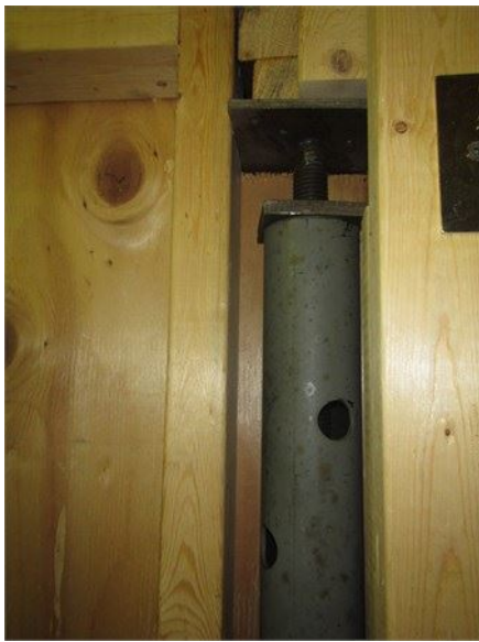
Poteau ajouté sans fixation sous une solive
