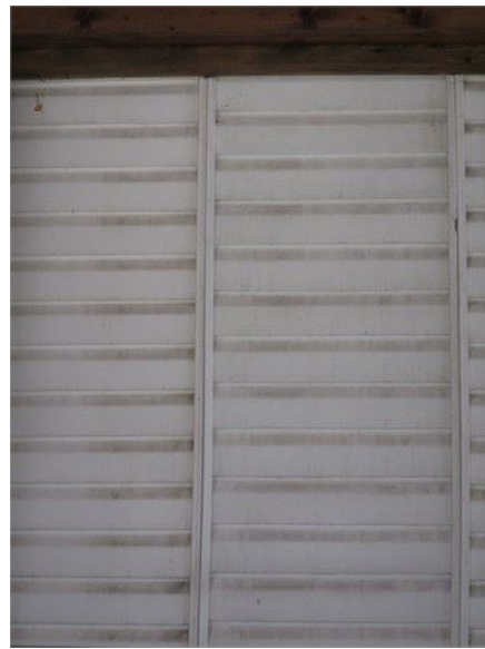
Assemblage fautif lors d'une réparation et traces d'écoulement d'eau venant de la jonction avec le toit de la terrasse à partir de laquelle nous prenons cette photo
