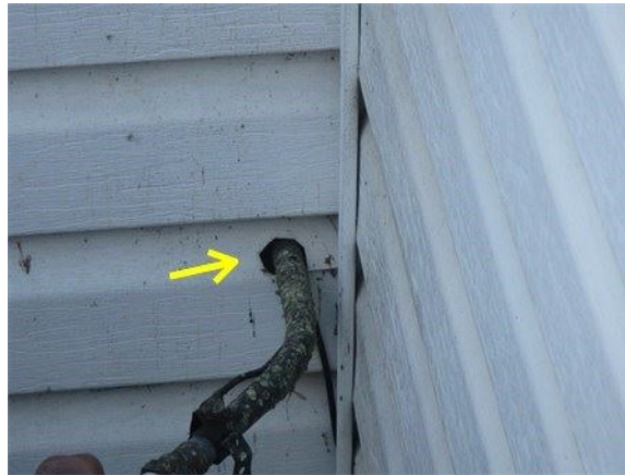
Exemple de scellant manquant
