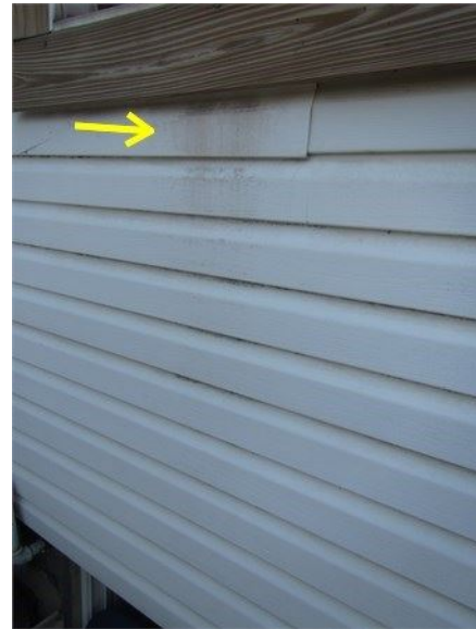
Traces d'écoulement d'eau sous une moulure décorative sous la fenêtre en raison de l'absence de solin d'étanchéité
