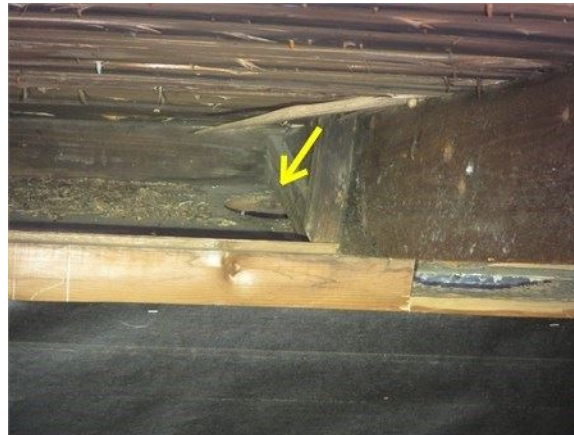
Quelques percements plus importants là où se trouvent les grilles rondes dans les soffites d'aluminium
