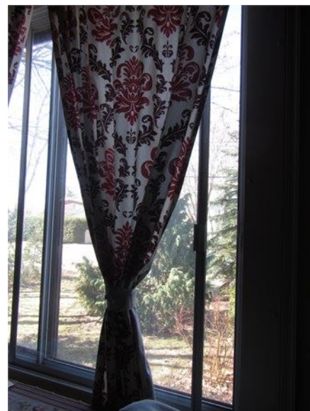
La fenêtre coulissante de la chambre principale avant est difficile à coulisser. Il pourrait s'agir d'infiltrations d'eau
