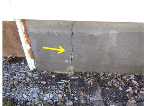
La fissure sur le coin arrière du mur latéral gauche
