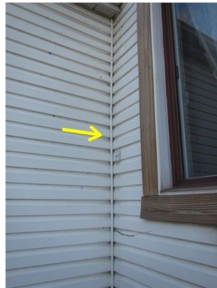
Coin inapproprié pour l'étanchéité
