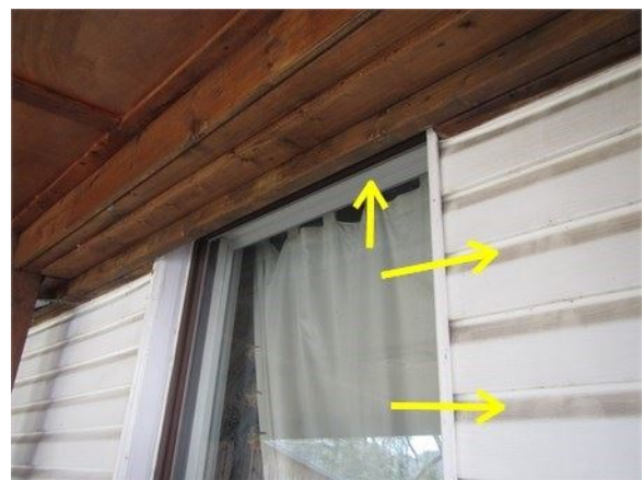
La structure du toit de la terrasse est trop basse sur la fenêtre, ce qui rend difficile le remplacement de la fenêtre / Notez également les traces d'écoulement sur le bardage de vinyle (flèches droites)
