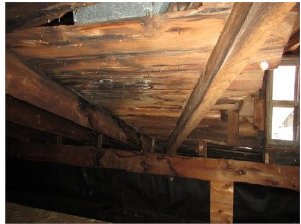
Structure de toit faible et traces d'infiltration d'eau qui pourraient être actives
