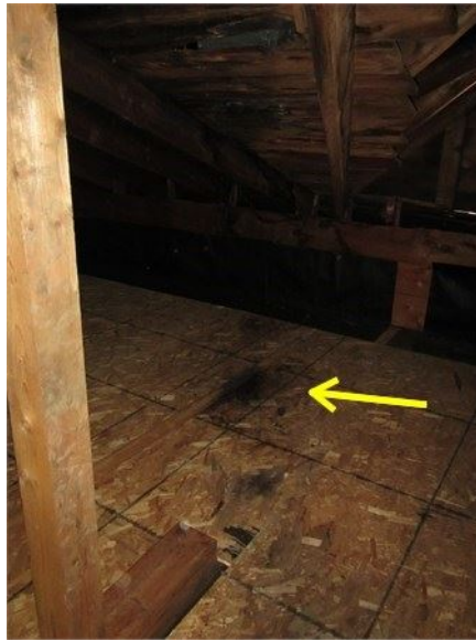
Taches au sol sous la possibilité d'une infiltration d'eau active dans l'entretoit
