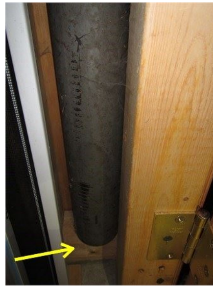
Poteau qui repose sur une base en bois sans fixation
