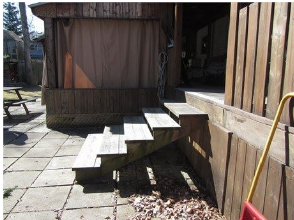
Absence de mains courantes et de garde-corps dans l'escalier arrière gauche
