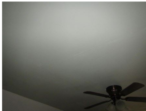
Crête rectiligne sur le plafond de la chambre arrière gauche
