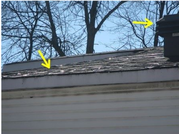
Câbles chauffants sur le débord de toit gauche malgré la présence d'un aérateur (flèche droite)
