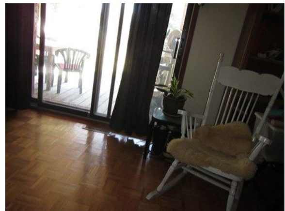
Le plancher de la chambre arrière centre penche vers la droite
