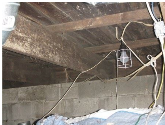
Taches sur des solives et le platelage de bois qui pourraient comporter des moisissures, vide sanitaire gauche
