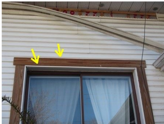
Absence de solins au-dessus des fenêtres et au-dessus des moulures décoratives
