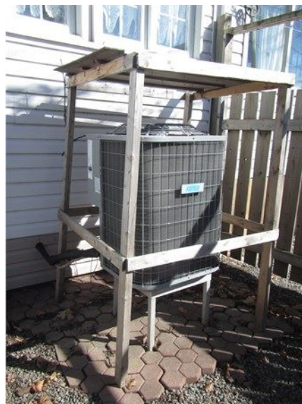
La thermopompe sur le mur latéral droit
