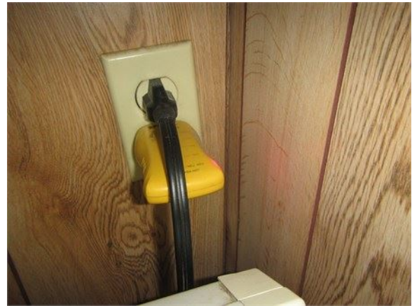
Prise dont les contacts sont inversés dans le sous-sol
