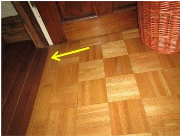
Le plancher de la chambre arrière centre a été ajusté à l'entrée de la pièce en raison de la dénivellation du plancher
