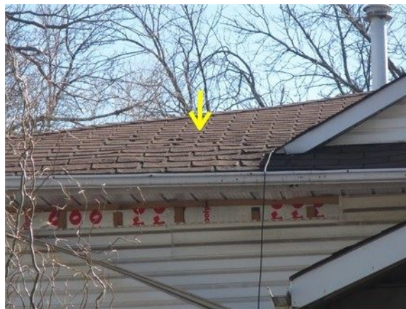
Bardeaux usés à remplacer sur la toiture
