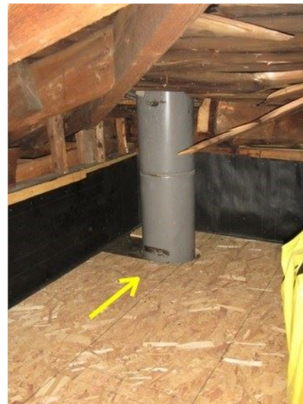
Absence d'espaceur autour du conduit de fumée dans l'entretoit
