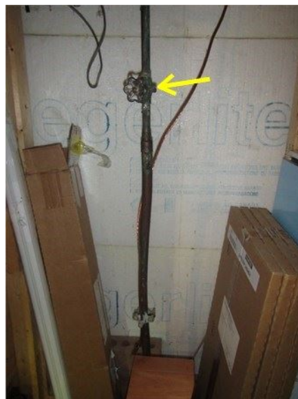
Vieux robinet d'arrêt d'eau à remplacer
