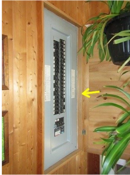
Le panneau de distribution électrique dans la salle à manger
