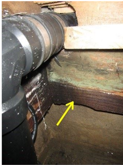
Bois mouillé et pourri dans le puisard gauche
