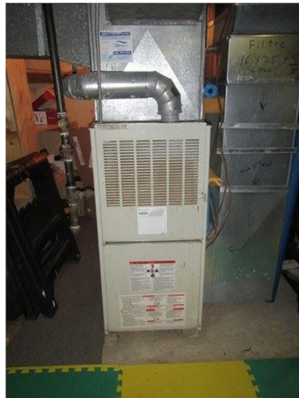
La fournaise au gaz au sous-sol
