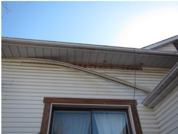
Section de vinyle arrachée à l'avant gauche
