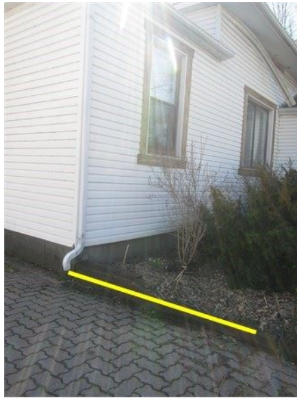
Absence d'exutoire à l'avant gauche
