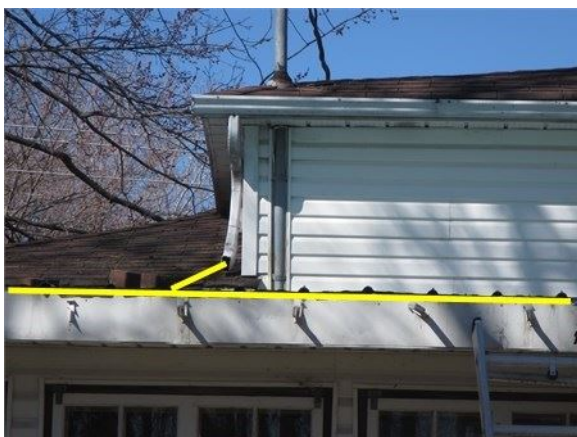
Absence de descente pluviale à partir d'une gouttière plus haut et absence de gouttière sur le débord de toit arrière droit
