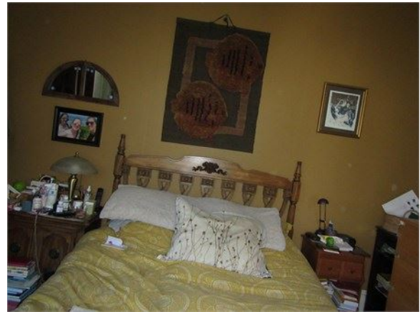
Le plancher de la chambre avant droite penche vers la droite
