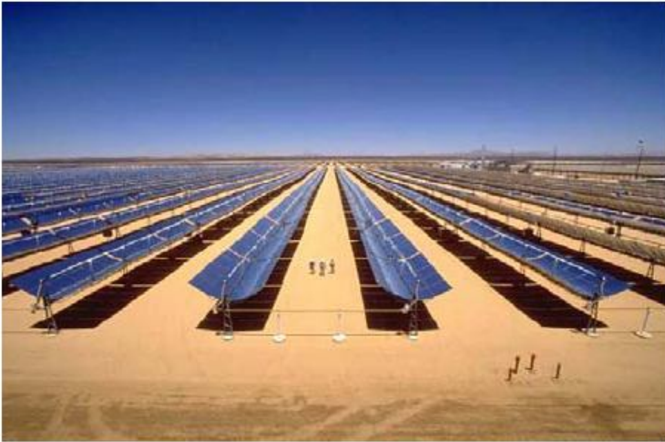
Figura 1.2 Vista di parte di un impianto SEGS a Kramer Junction
