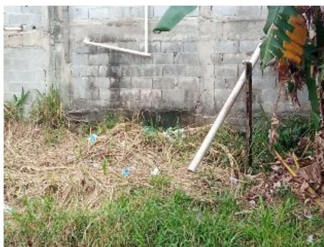
Foto 6 – Detalhe do encanamento posicionado para despejo de efluentes domiciliares direto no Rio Aricanduva
