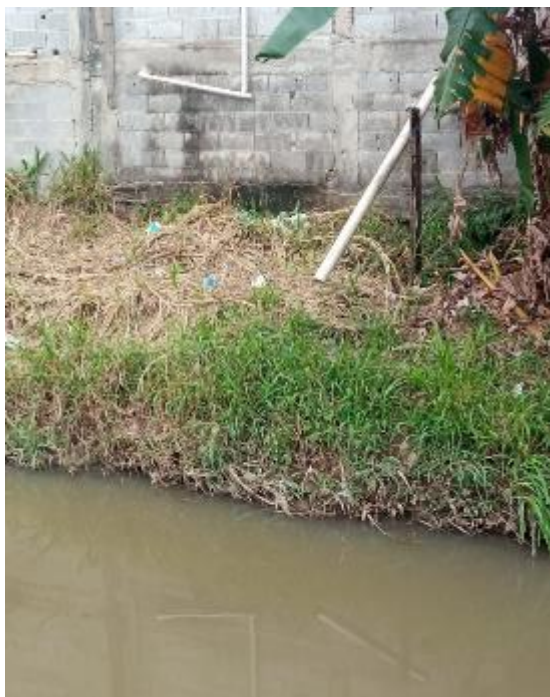
Foto 168 - Lançamento irregular de água/esgoto. Fonte: SIURB, 2023.
