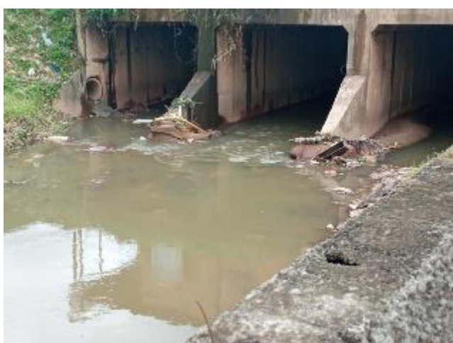
Foto 1 – Galerias para passagem das águas fluviais do Rio Aricanduva, abaixo da Av. Jacú-Pêssego / Nova Trabalhadores
