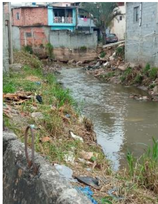
Foto 169 - Lançamento irregular de água/esgoto. Fonte: SIURB, 2023.
