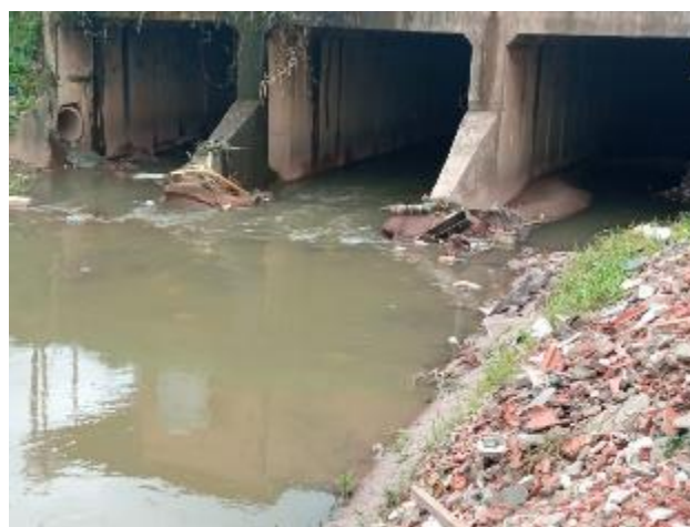
Foto 171 - Descarte irregular de resíduos observado nas vias do entorno e junto ao curso d'água. Fonte: SIURB, 2023.
