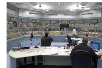
Sala do centro de controle de usina nuclear
