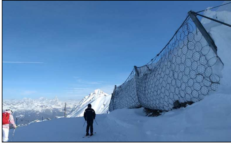
Barriere paramassi con funzione anche di fermaneve
