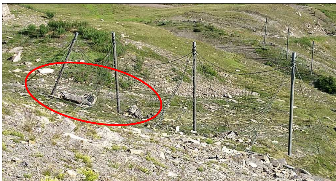
Reti da neve Dk 3.0 m parzialmente danneggiate: particolare dei blocchi
