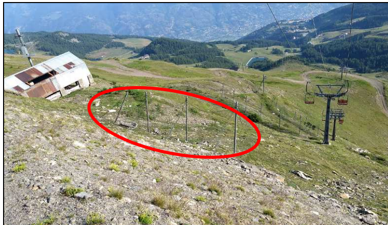
Reti da neve Dk 3.0 m parzialmente danneggiate: particolare dei blocchi
