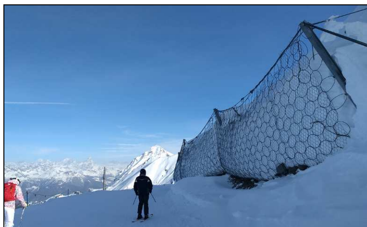
Barriere paramassi esistente con funzione anche di fermaneve: come si evince, le stesse sono in grado di resistere ai crolli dei blocchi ed alla spinta della neve
