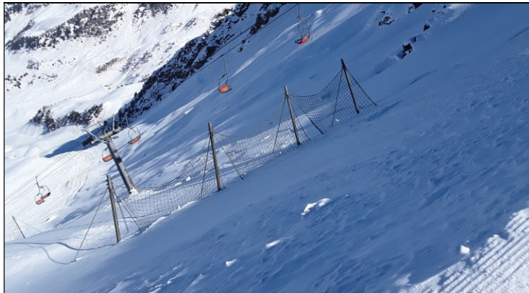
Reti da neve Dk 3.0 m parzialmente danneggiate a causa dell'impatto di alcuni blocchi
