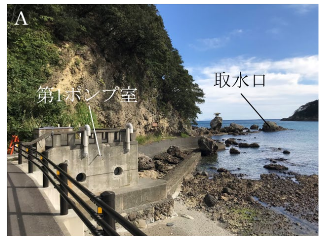
2. 第1ポンプ室(A)および第2ポンプ室(B).
