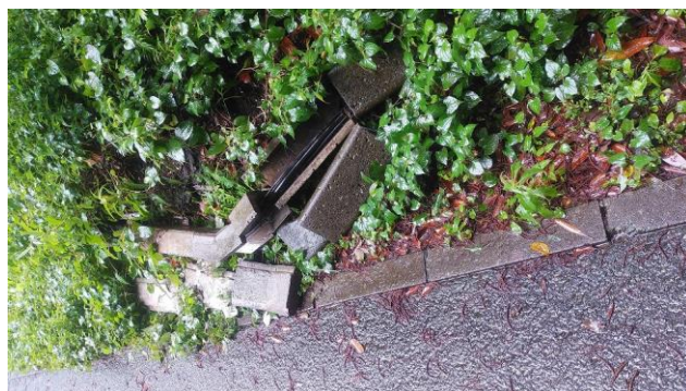
図1. 大雨により崩落したケーブル保護ブロック
