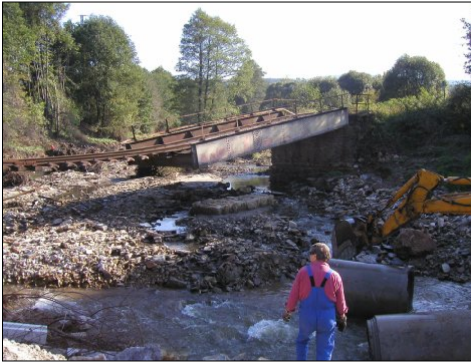
Obrázek 3 Železniční most na Blanici, stržený během povodně v srpnu 2002. Nedostatečně dimenzovaný profil mostní konstrukce významně přispěl k rozsahu destrukce. Foto SGG, 2002
