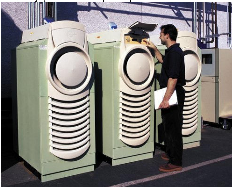
Obrázek 40 Kogenerační jednotka se spalovací turbínou
