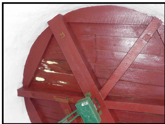
Le plafond sous la lanterne avec la moisissure Photo : Jean Cloutier
