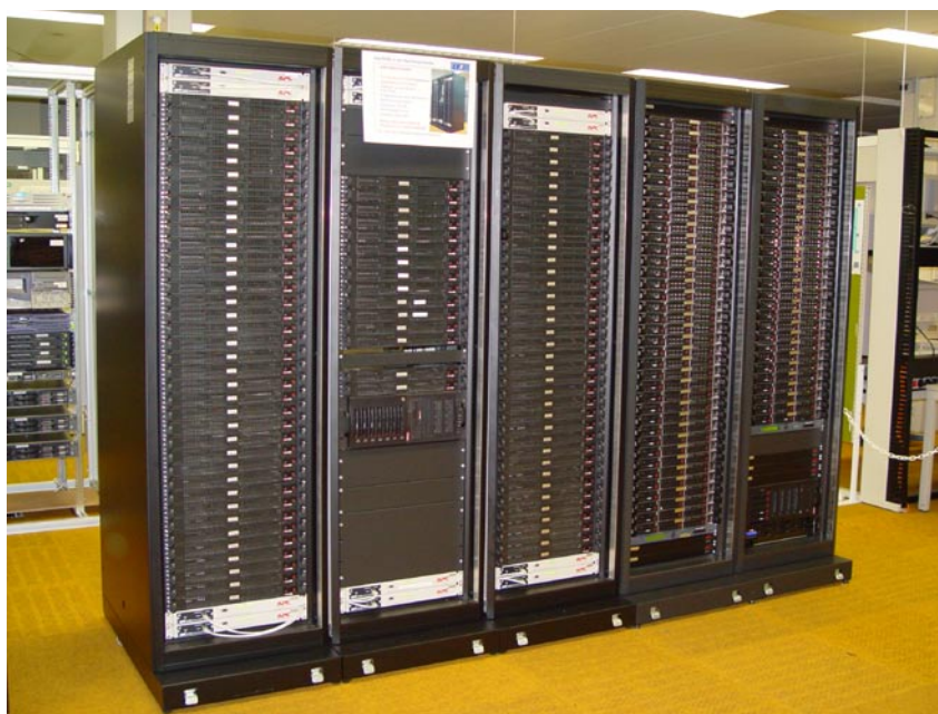
Das IA32/EM64T-Cluster am RRZE. Die Erweiterung mit den neuen Knoten befindet sich in den beiden rechten Schränken
