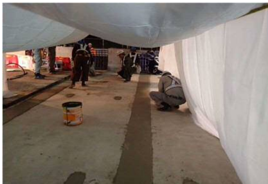
【雨天対策設備設置状況】
