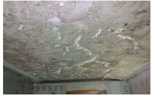
既存床版の損傷状況
