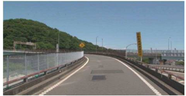
既存床版の損傷状況
