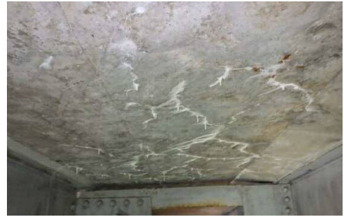
既存床版の損傷状況
