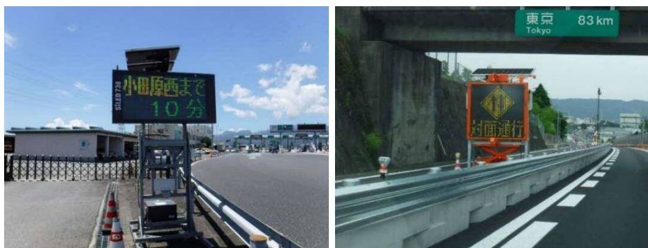
【簡易LED情報板設置状況】
