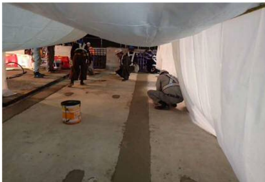
【雨天対策設備設置状況】
