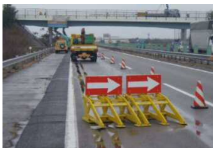
【物理的防御装置設置状況】
