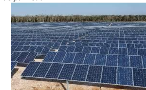
Photo 14 : Installation photovoltaïque terminée
