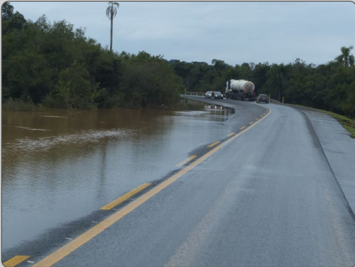
Figura 21 – Cheia do Rio Iguaçu provoca enchente na região de São Mateus do Sul-PR.
