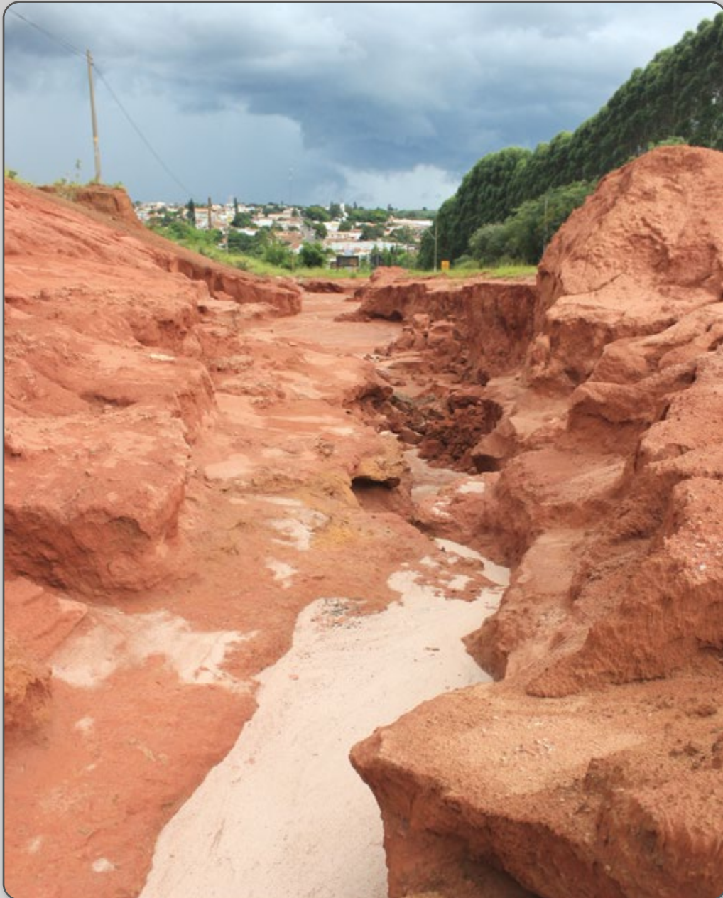
Figura 128 – Erosão em área de solo vulnerável.
