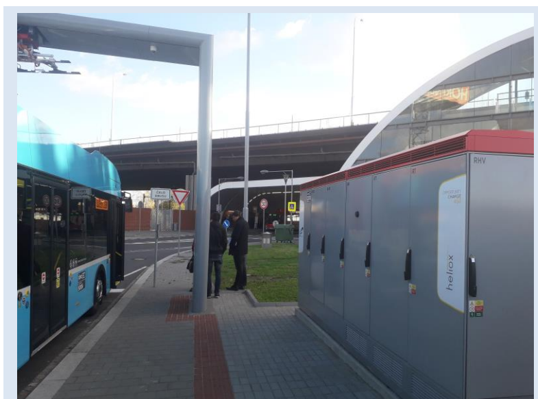
Obr. 39 Nabíjecí stojan OppCharge a kabinety s energetickým zařízením pro nabíjecí výkon 450 kW v Ostravě-Svinově
