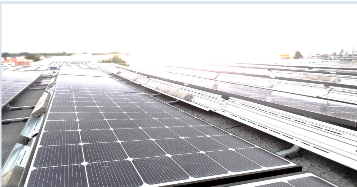
Obr. 35 Příklad fotovoltaického zdroje na velkoplošné střeše (servisní centrum)
