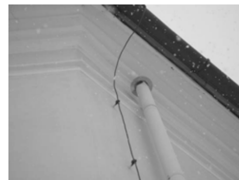
Obrázek 3: Vyvedení vnitřního větracího systému pod římsu kostela
