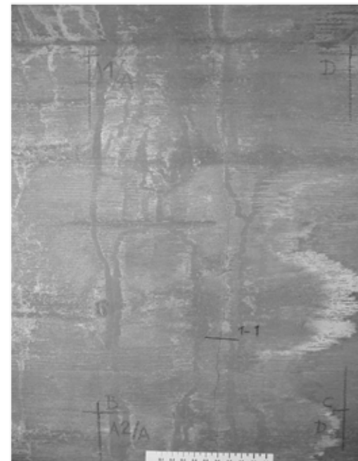
Obr. 6 - Fotografie- referenční plocha A, záběr 1, (trhlina č. 1, měřené místo č. 1)
