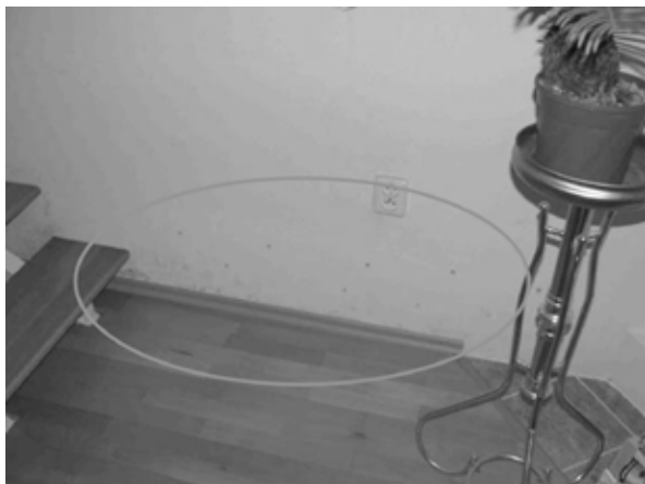
Obr. 1: Fotografie povrchu stavební konstrukce s vlhkostní mapou ve spodní části
