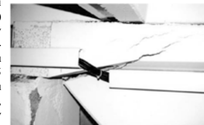
Obr. 10 Zjištěná trhlina ve smykové oblasti střešního vazníku
