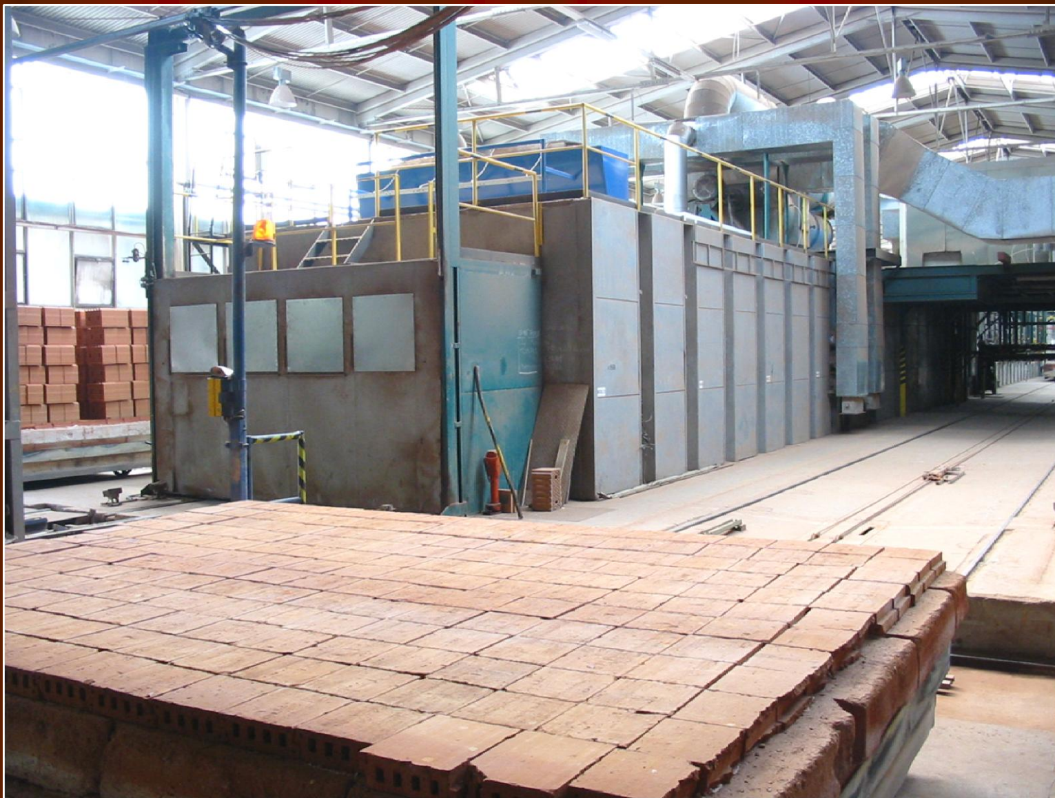
Tunelová pec a pecní vůz pro výpal výsušků
