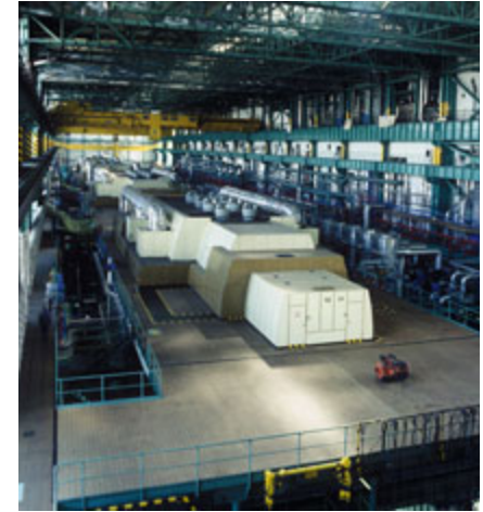
Každý, kdo jadernou elektrárnu navštívil, je ohromen složitostí technologie a řídicího systému. Pohled do strojovny Jaderné elektrárny Dukovany.
