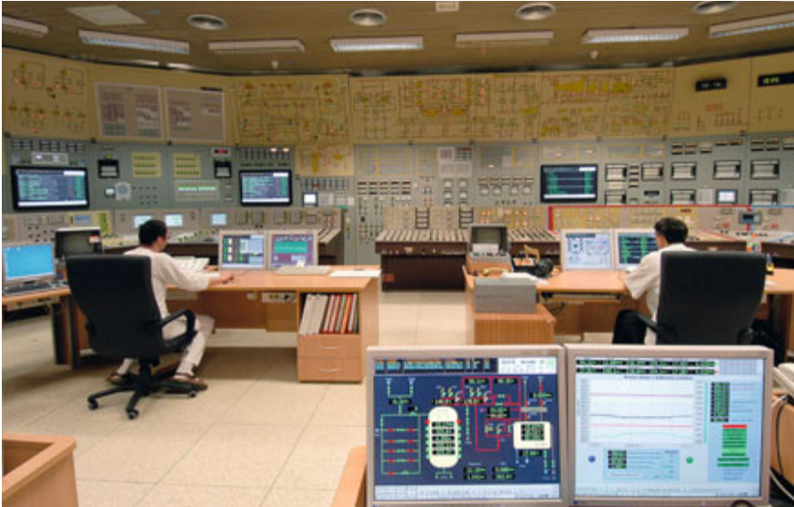
Bloková dozorna Jaderné elektrárny Dukovany
