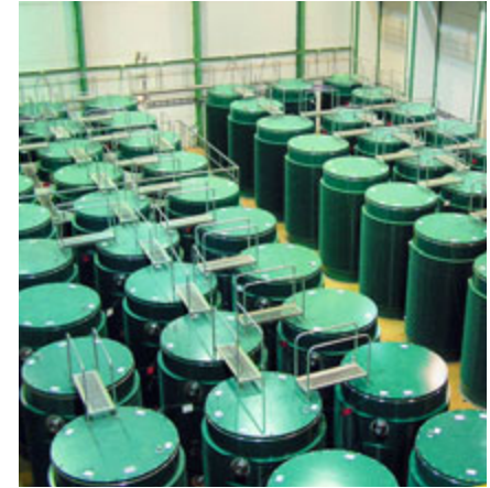
Kontejnery v prvním ze skladů použitého paliva v Jaderné elektrárně Dukovany (suchý sklad)
