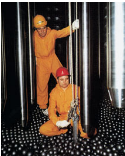
Pohled do reaktoru demonstrační elektrárny HTR-300
