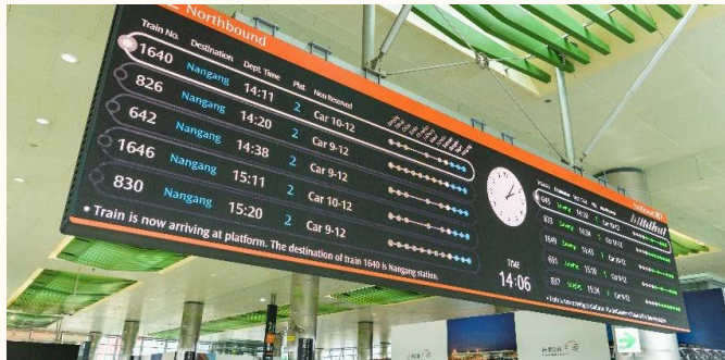
車站旅客資訊系統更新
