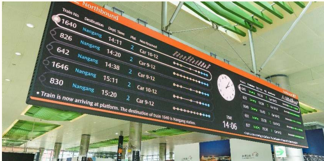
車站旅客資訊系統更新
