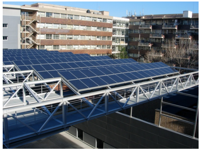
Figura 51. Instal·lació fotovoltaica a l'Atri Solar de les facultats de Física i de Química. Banc d'imatges OSSMA.
