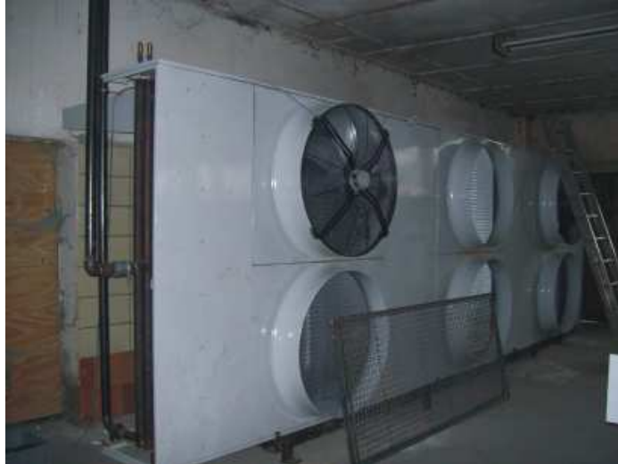
Abb. 56 Wärmetauscher in Halle 4
