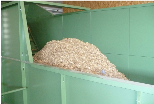
Abb. 73 Trockengut im Dosierer
