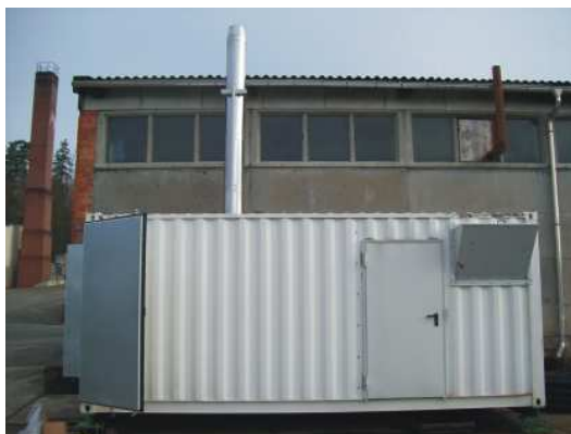
Abb. 54 Containeranlage an Halle 4
