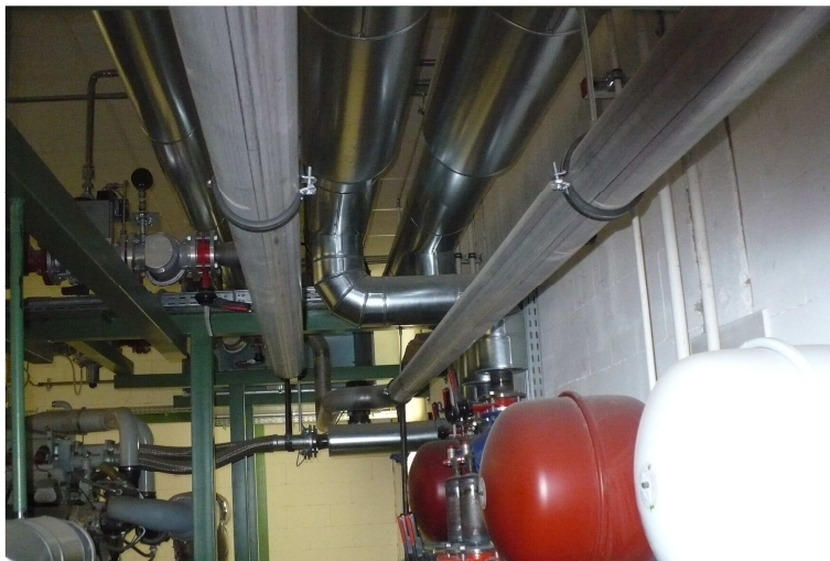
Abb. 69 Abwärmesystem an den BHKW I und BHKW II
