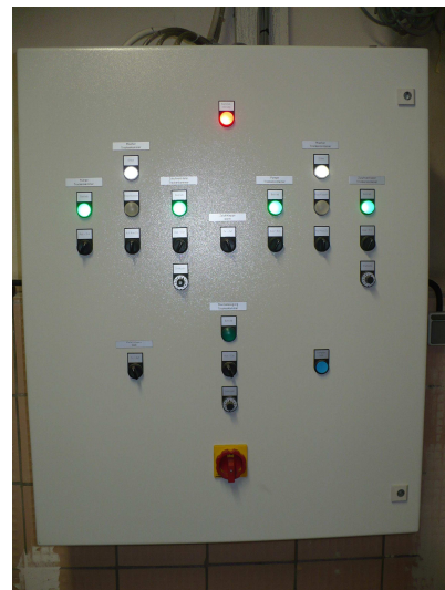
Abb. 84 Steuerung für Trockenkammer
