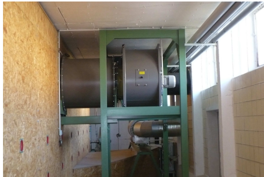
Abb. 79 Abluftsystem des Bandtrockners
