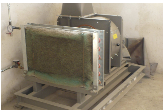
Abb. 87 Wärmetauscher mit Ventilator
