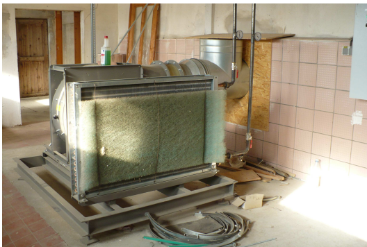
Abb. 83 Wärmetauscher für Trockenkammer
