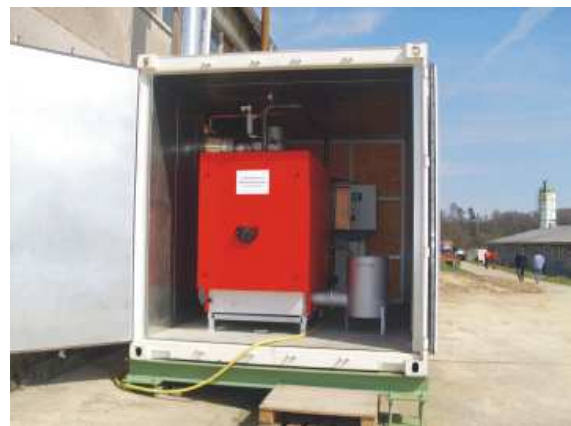
Abb. 55 Heizraum mit Aschebehälter
