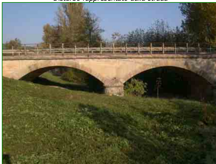
Progressivo accumulo di materiale detritico sotto il ponte
