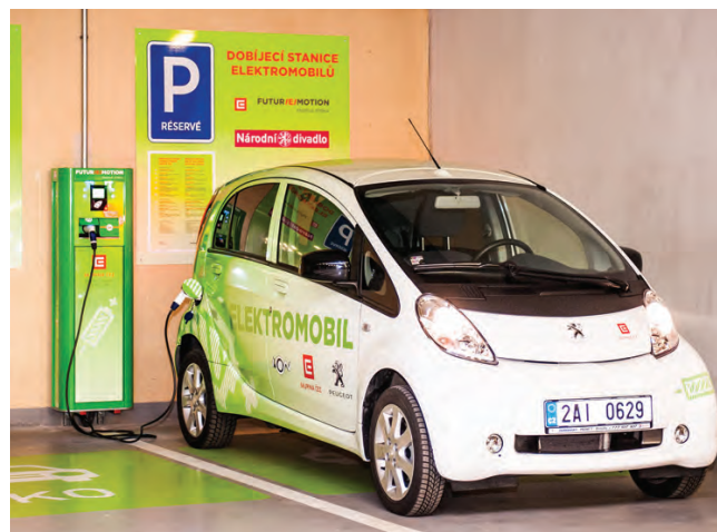
Obr. 9: AC dobíjecí stanice ČEZ na parkovišti v budově Národního divadla Zdroj: ČEZ, a.s.
