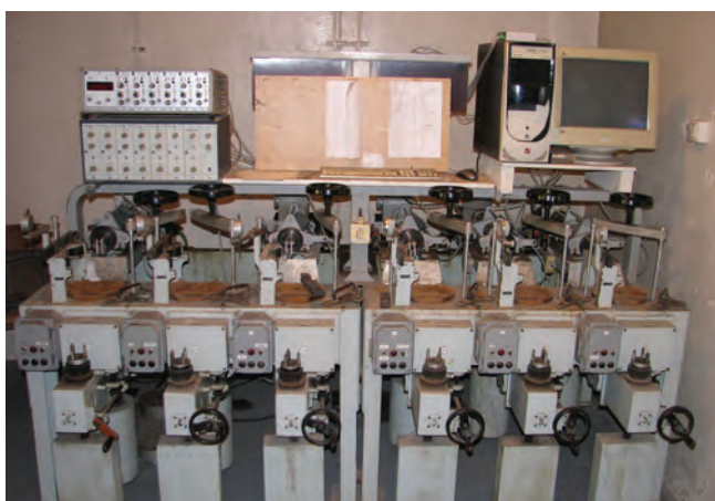
Obr. 4: Celkový stav a konfigurace přístroje před rekonstrukcí
