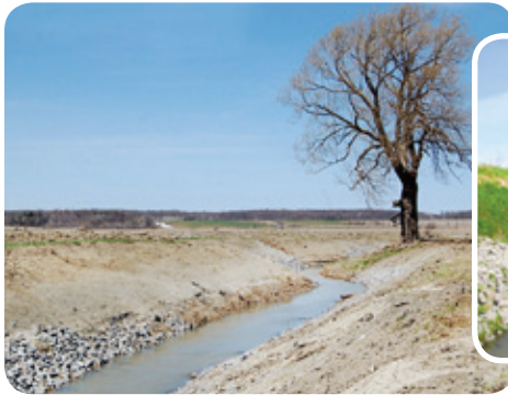
Stabilisation de berge à l'aide d'enrochement, au printemps, peu après les travaux.
