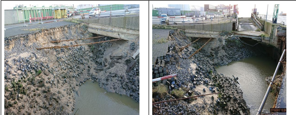
Abbildung 4: Versackung – ausgelöst durch die Havarie 2017
