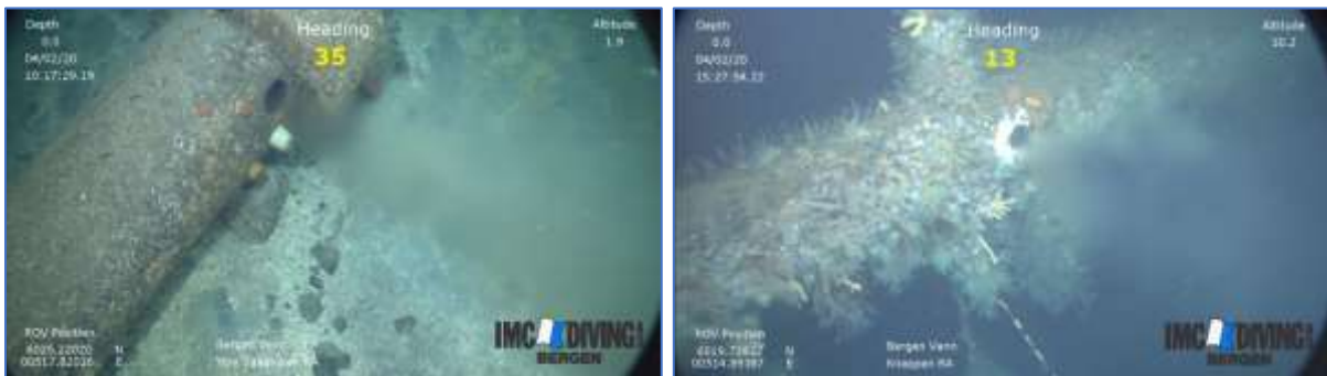
Figur 52. Avløpsrør med diffusoråpninger med aktivt utslipp ved Ytre Sandviken (38 m dyp) og Knappen (40 m dyp).
