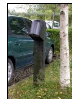
Exemple d'éclairage au sol
