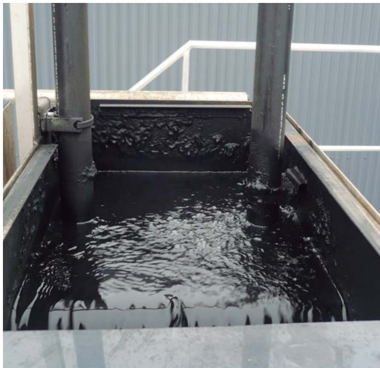
Figura 2. Aspecto de la mezcla con carbón activo en polvo en el retorno al tanque de contacto
