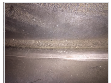
Bild 6. Befunde an einer Dampfturbine, Detailansicht.
