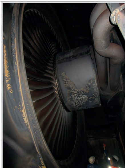
Bild 2. Befunde an einer Dampfturbine.
