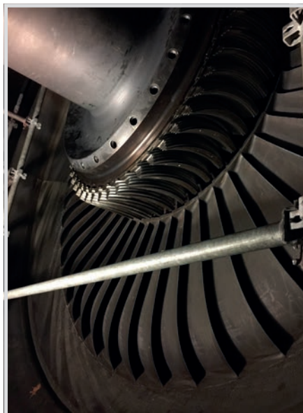
Bild 3. Befunde an einer Dampfturbine.
