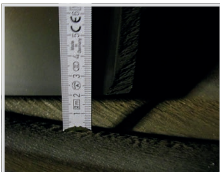
Bild 4. Befunde an einer Dampfturbine, Detailansicht.
