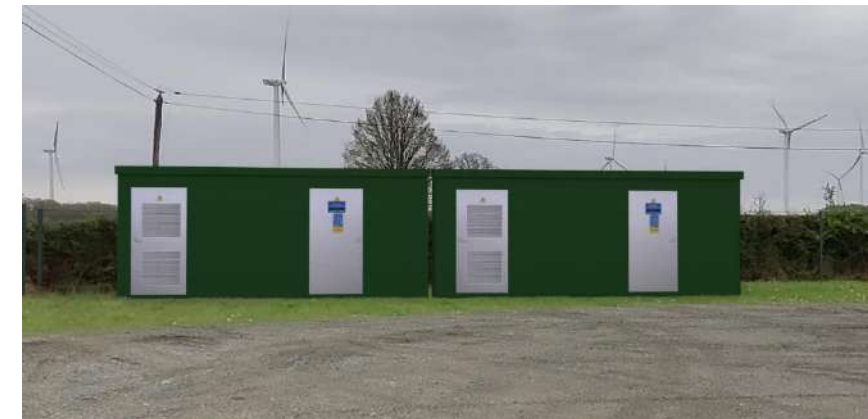
Figure 21 : Exemple de poste de livraison – Source : 3D Vision
