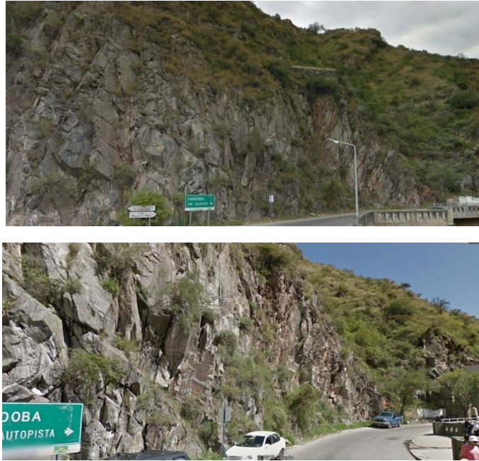
Figura 106. Estribo derecho de presa. Talud vertical con alto potencial de caídas de rocas. Fuente: propia
