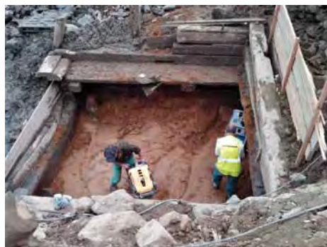
Obr. 14, 15. Odkrývání vtokové šachty starých spodních výpustí u návodní paty v pravé nejvyšší části hráze; na obrázku vpravo jsou ve dně šachty směrem doprava viditelné začátky dvou potrubí z jedlového dřeva, každá trouba byla geodeticky zaměřena do délky 82 m (TV kamera dostoupila u levé výpusti do 44 m, u pravé trouby do 27 m); průtočný průřez obou potrubí: v = 60 \text{ cm} , \bar{s} = 40 \text{ cm} ; dřevo shledáno v dobrém technickém stavu (zkoušky DNA potvrdily, že dřevo pochází z konce 15. století); dole vlevo sanace šachty jílem a vpravo vodárenský objekt v horní části návodního svahu
