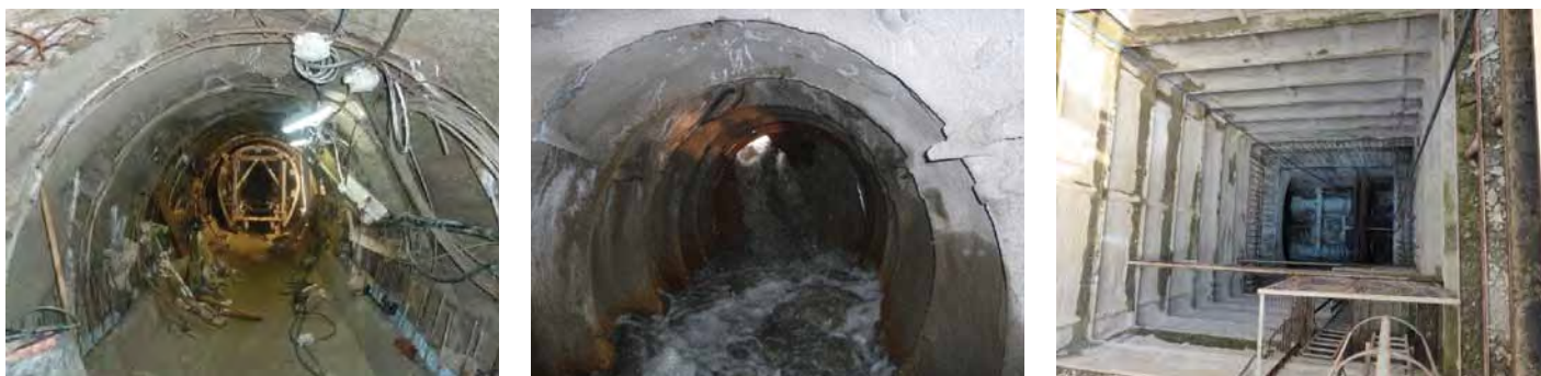
Obr. 1, 2, 3. Zleva doprava: betonáž beztlakové štolý, proražení ze dna nádrže do tlakové štolý, pohled shora do šachty uzávěrů během stavby
