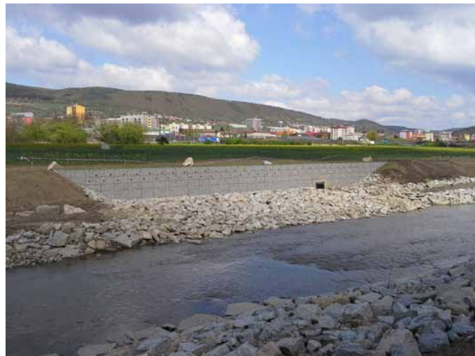
Foto 12. Litavka, Králův Dvůr – levý břeh s gabionovou zdí a vloženými trubkami pro hnězdění břehuli říční
