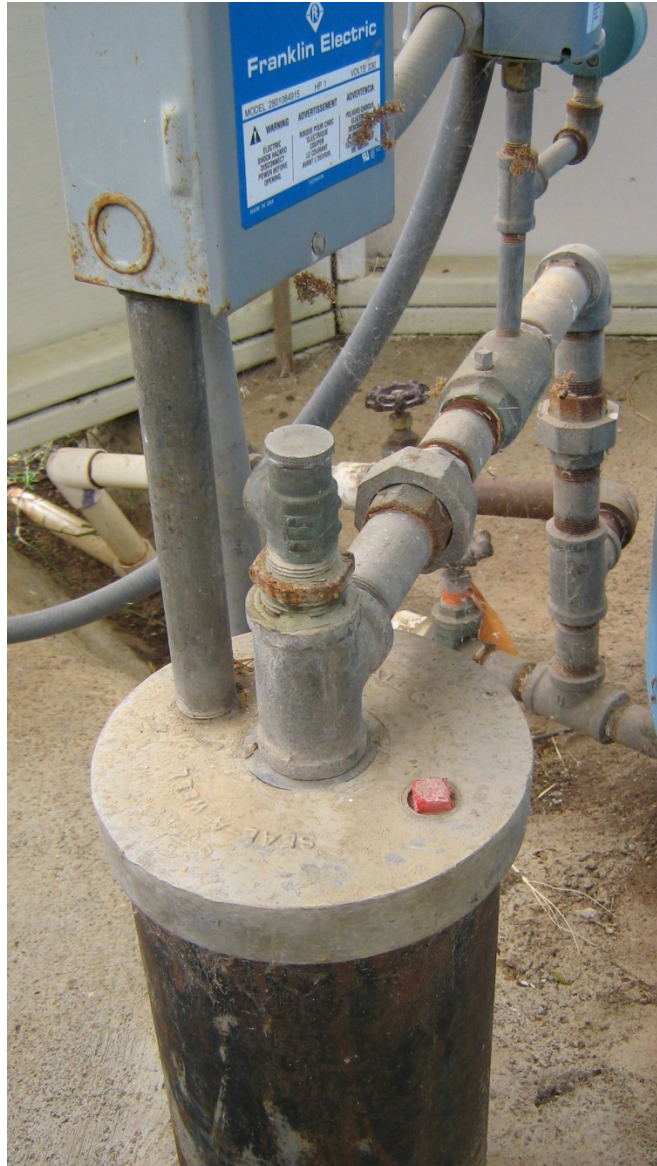
Figura 9. Foto: Pozo doméstico donde se pueden ver el revestimiento del pozo, la tapa y el sistema de distribución.
