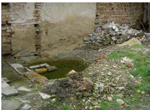
Отходна яма, пълна с отпадъчни води
