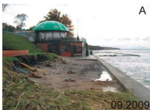
Ryc. 39B. Zmiany plaży w Kołobrzegu, rejon Szańca Wschodniego 2009–2012, A – sztorm z 17.09.2009, woda niszczy łód ponad opaską (3,5 m n.p.m.), B – sztorm z 06.01.2012, woda przelewa się ponad opaską, C – kwiecień 2012, D – po najnowszej refulacji, sięgającej opaski, 11.2012
