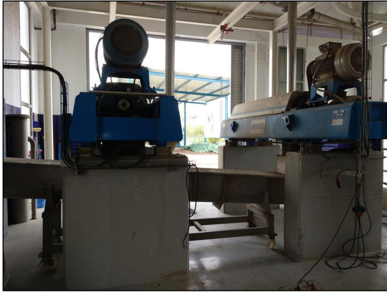
Figura 15. Sistema de centrifuga del fango de la EDAR de Tudela.
