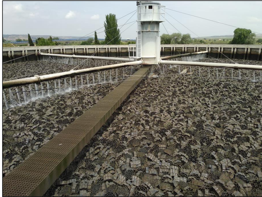
Figura 13. Interior del cilindro de tratamiento secundario de la EDAR de Tudela.
