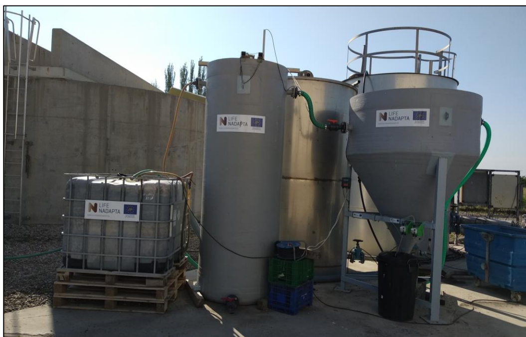
Figura 19. Planta piloto para la recuperación de fósforo. De izquierda a derecha: Contenedor de trasvase, reactor agitador y decantador.
