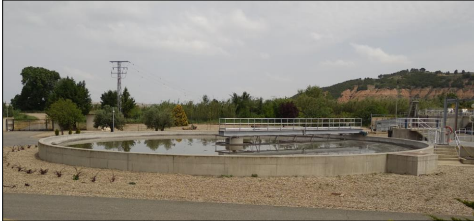
Figura 12. Decantador primario de la EDAR de Tudela.
