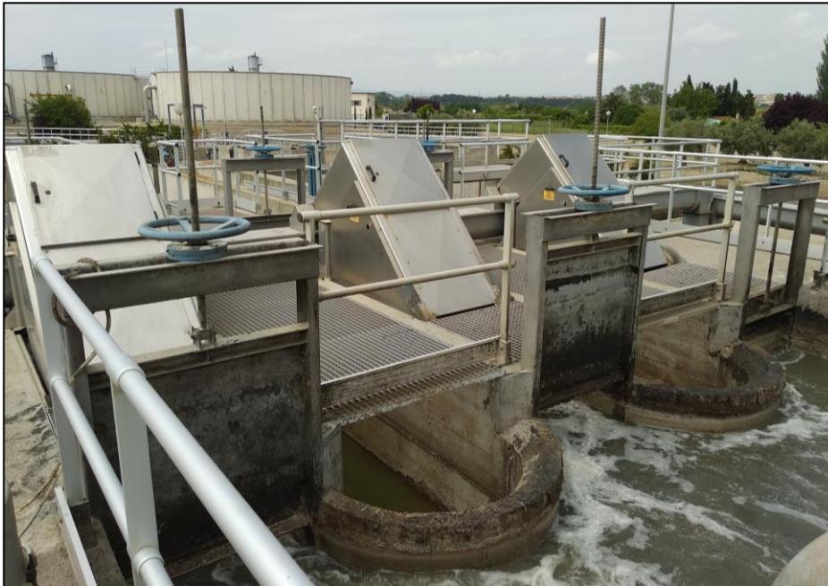
Figura 11. Etapa de pretratamiento de la EDAR de Tudela.
